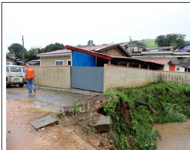
FOTO 3 – Detalhe da moradia atingida, quando da ocorrência de inundações, na margem direita do rio do Peixe, ao lado da ponte da Rua Maranhão.
