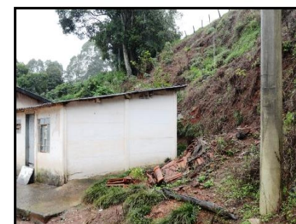
Detalhe da proximidade das moradias à encosta.
