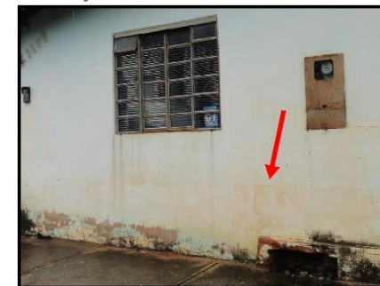
Detalhe de uma moradia na Av. Prefeito Oswaldo Lopes, com marcas de nível d'água de inundação (seta vermelha).
