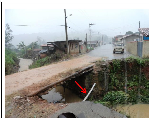
FOTO 5 – Visão geral do ponto a montante, mostrando a travessia sobre o rio do Peixe e a rua Maranhão atingida pela inundação. Notar o cano de água (seta vermelha), que frequentemente é quebrado pela força das águas do rio, quando da ocorrência de inundações.
