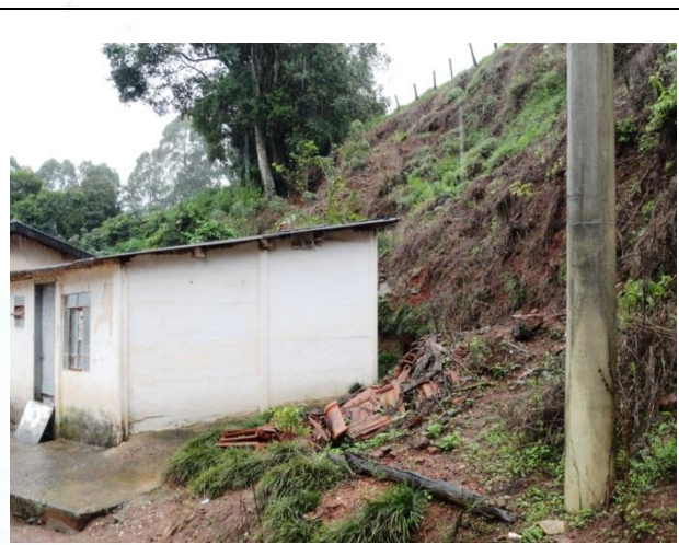
FOTO 18 – Detalhe da proximidade das moradias à encosta.
