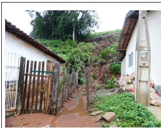
FOTO 19 – Detalhe do processo erosivo no talude de corte ao fundo de uma das casas.
