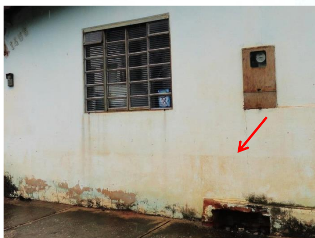
FOTO 15 – Detalhe de uma moradia na Av. Prefeito Oswaldo Lopes, com marcas de nível d'água de inundação do rio do Peixe.
