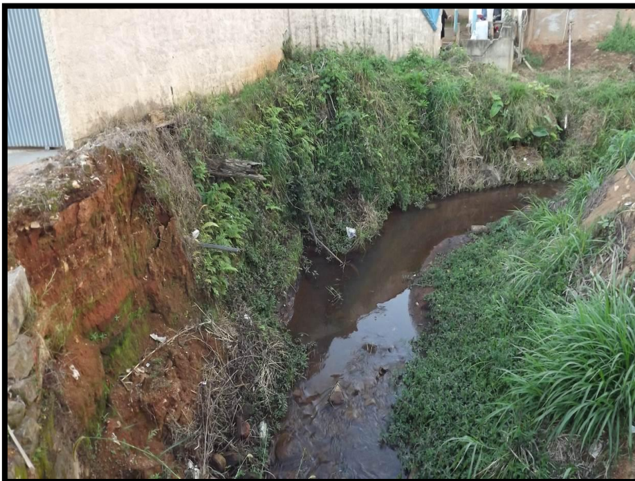
Imagem 65 - Local com perigo de desmoronamento de moradias
