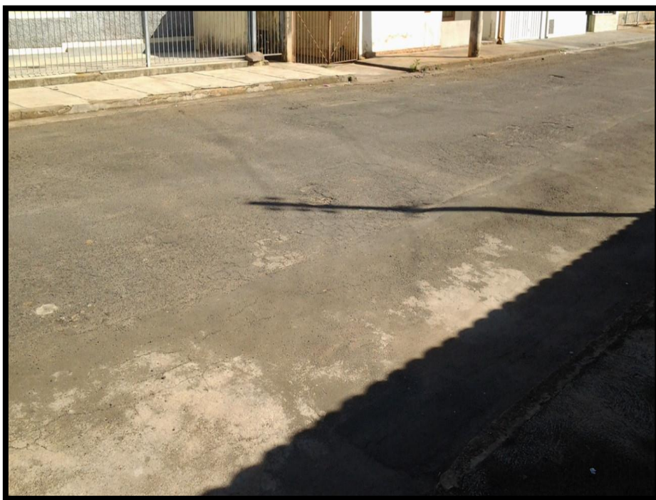
Imagem 55 - Ponto de Alagamento
