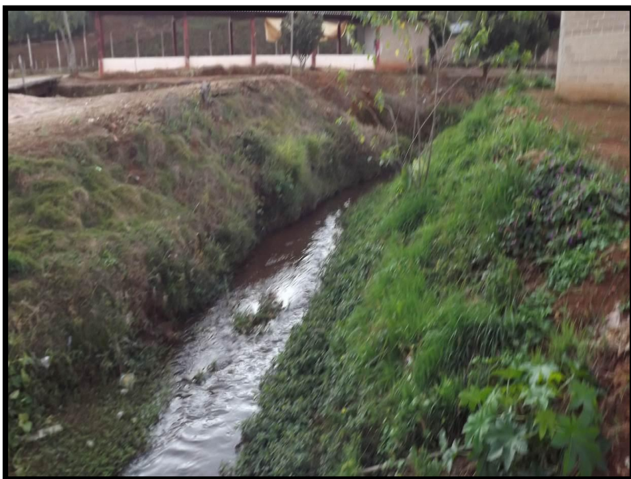
Imagem 69 - Risco de desmoronamento – Afluente do Rio do Peixe
