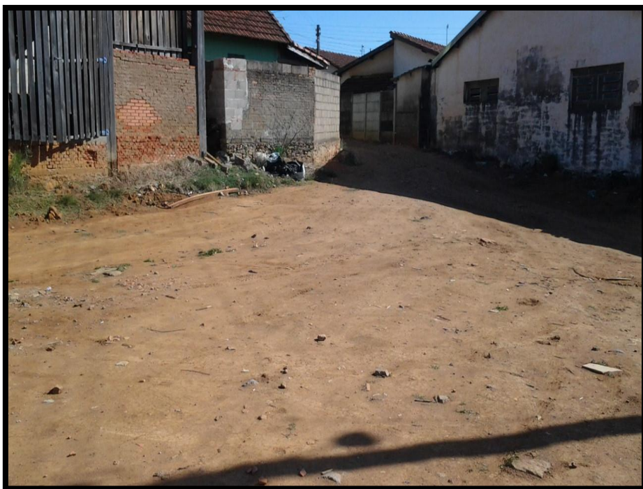
Imagem 57 - Ponto de Alagamento, Rua Acre
