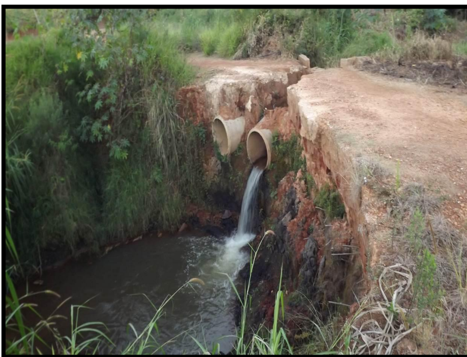
Imagem 66 - Passagem danificada no Bairro Três Barras
