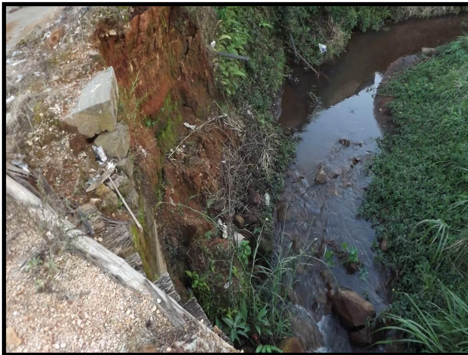
Imagem 63 - Risco de desmoronamento – Afluente do Rio do Peixe
