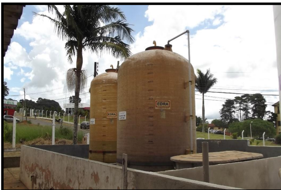
Imagem 6 - Tanque para os produtos químicos
