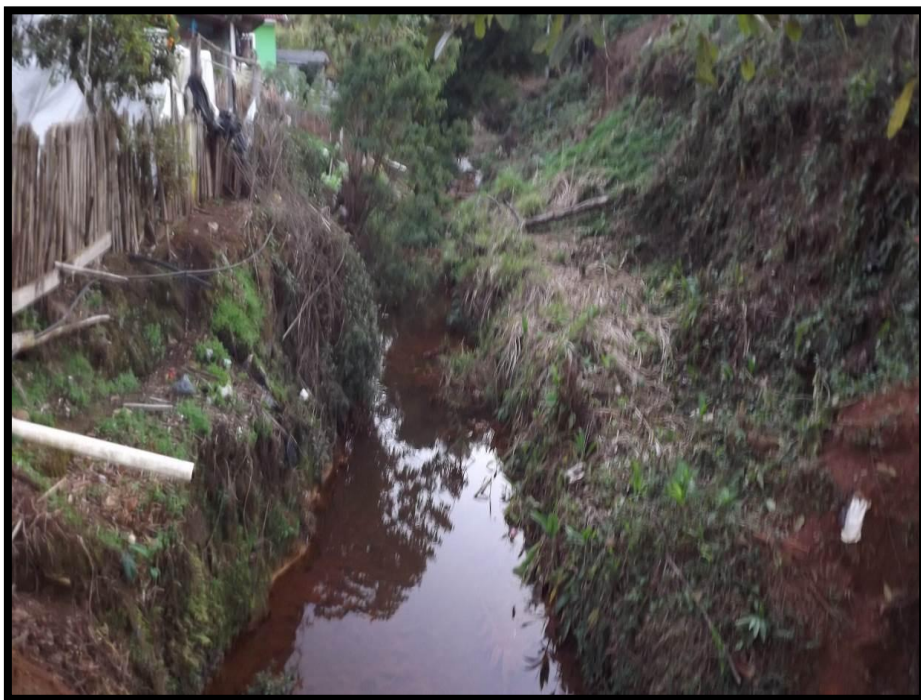
Imagem 70 - Risco de desmoronamento
